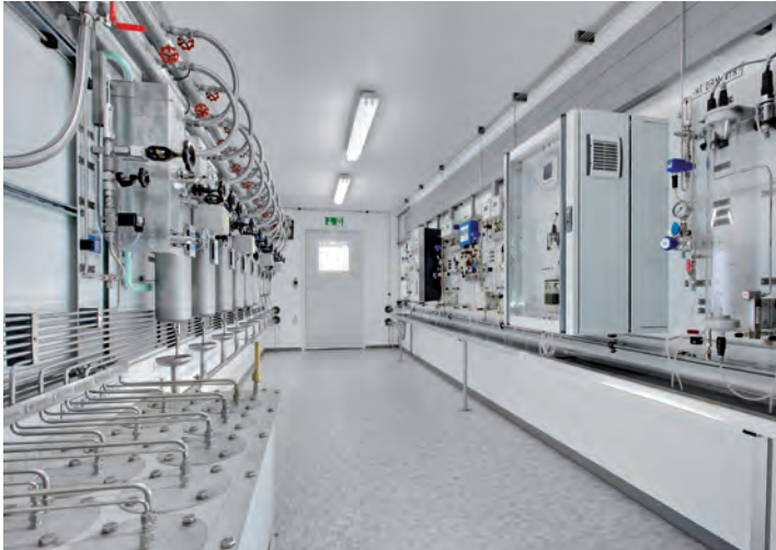
Sekundärkühlung mit Isothermalbad Secondary cooling system with isothermal bath
