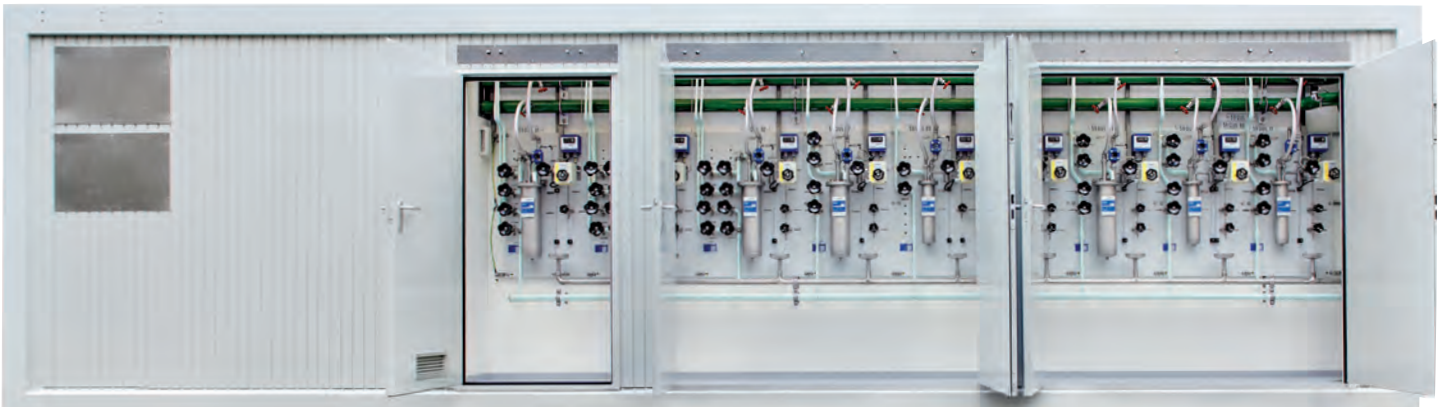
Container mit separat angeordneten Probenahmekühlern Container with separately arranged sample coolers
